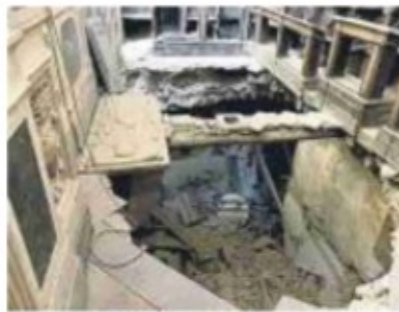
Il crollo alla chiesa degli Incurabili
